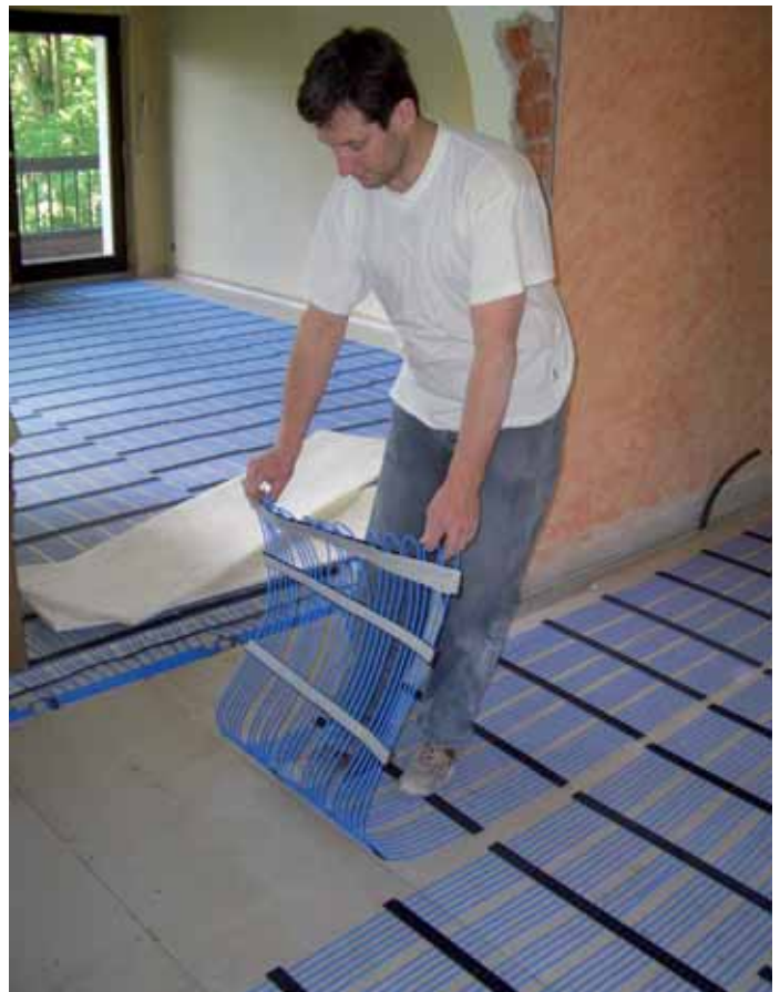
Einbau einer Fußbodenheizung (Kapillarrohrsystem) im Altbau. Die Vorteile der Erdwärmenutzung zeigen sich vor allem in Kombination mit Niedertemperatur-Heizsystemen.
